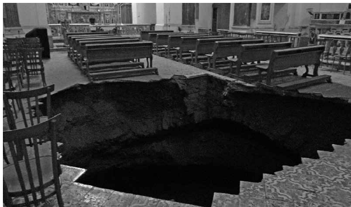
La voragine all'interno della Chiesa
